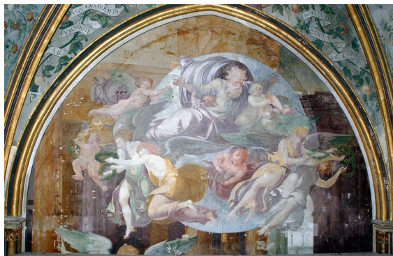
Fontaine-Chaalis (60), chapelle de l'ancienne abbaye de Chaalis, étude des peintures murales du XVIIe s. attribuées au Primatice (© LRMH)
